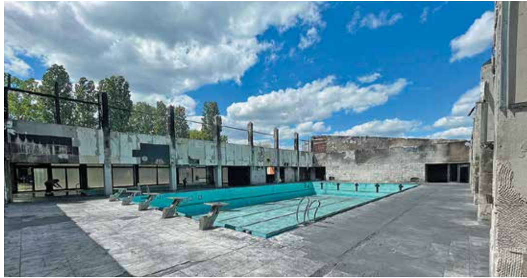
Az uszodatér felett teljesen elbontották a leégett tetőszerkezetet
