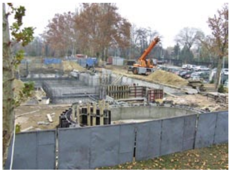
Óvási úcsörgő, melegvízű gyermekmedence és egy többfunkciós élményfürdő épül a mátyásföldi uszoda szomszédságában, a Progress Zrt. kivitelezésében
