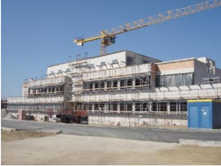
Szerkezetkész az analitikai laborépület. Tervezője Korma Sándor (Multiplan Kft.), a generálkivitelező a gödöllői Bau-Trade Kft.
