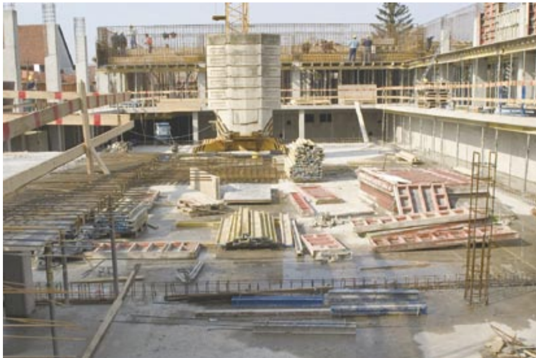
Az uszodatér a Csömöri út irányából. Ide kerül majd a rozsdamentes acélból készülő úszómedence
